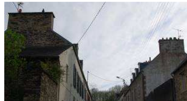
Les souches de cheminée sont positionnées en pignon. Elles sont en moellons montés au mortier de chaux.
