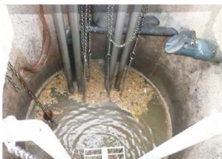
Figure 14 : poste de refoulement en entrée de station d'épuration
