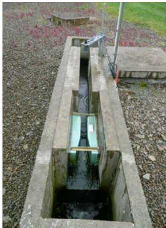
Figure 17 : canal de mesure de débit en sortie de station d'épuration
