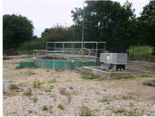
Décanteur digesteur – Station d'épuration
