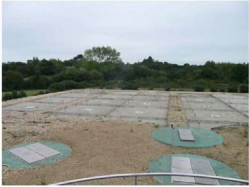
Filtres à sable
