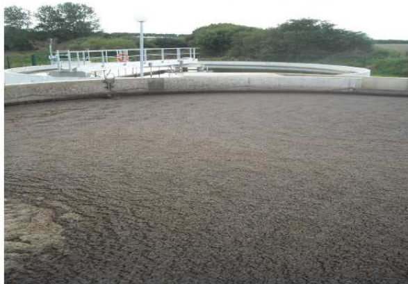
Bassin d'aération et clarificateur
