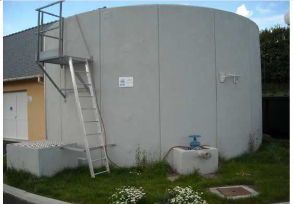
Cuve à boues liquide
