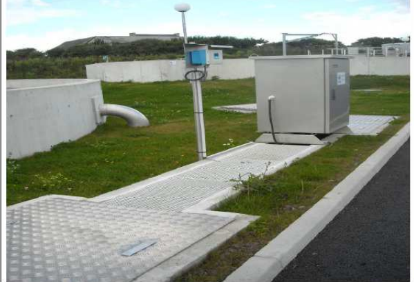
Canal et préleveur de sortie
