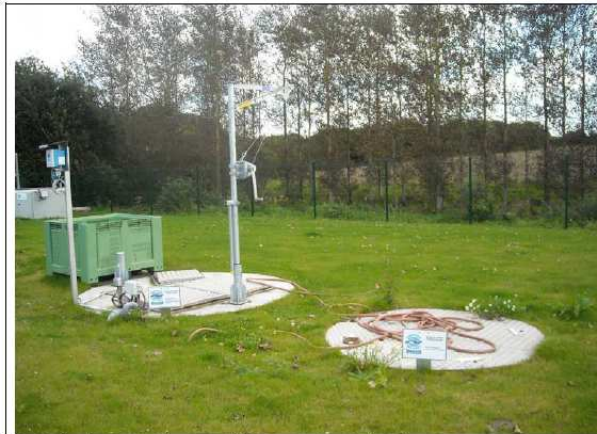
Poste de relevage entrée ; regard de vannes et poste de relevage secours
